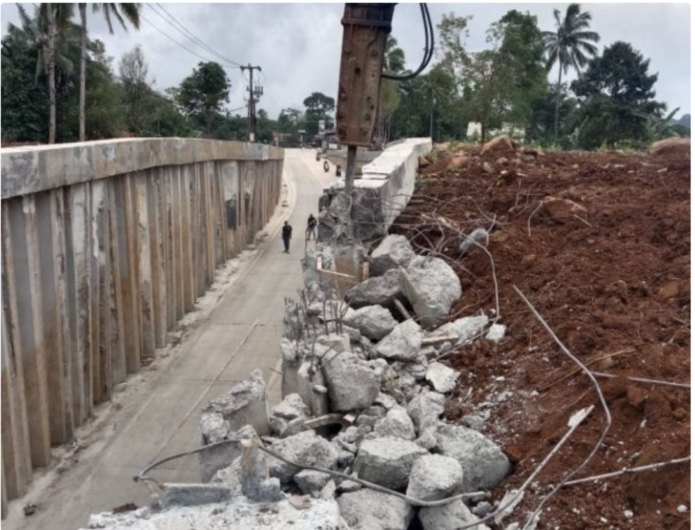
Diduga Proyek Gagal Kontruksi
